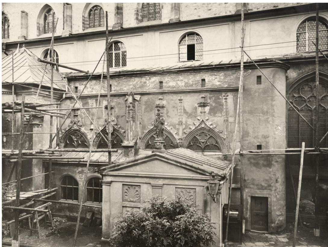
II. 124. Kłodzko, kościół Wniebowzięcia NMP, stan podczas prac konserwatorskich przy elewacji północnej. Instytut Herdera NBA 56056.
