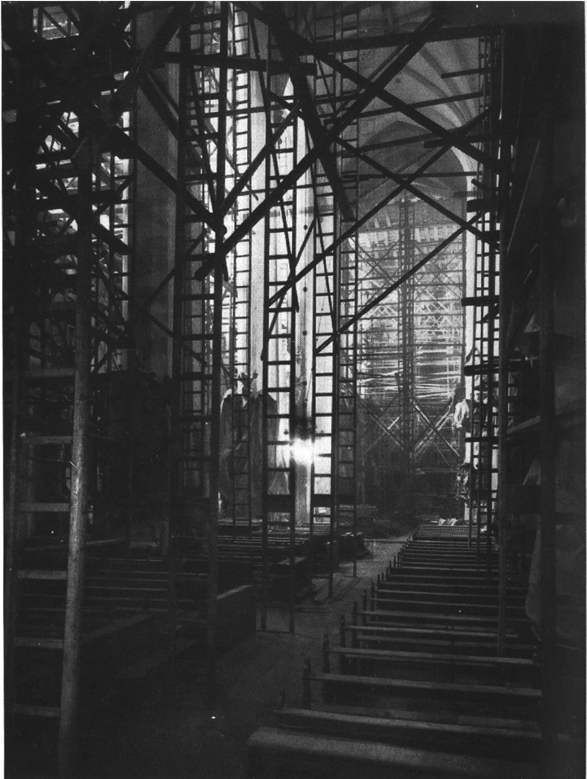
II. 103. Wrocław, kościół św. Stanisława, Doroty i Wacława, wewnątrz podczas prac konserwatorskich w latach 1933-1937. Jahresbericht des Provinzialkonservators der Kunstdenkmäler Niederschlesiens für die Jahre 1935, 1936, 1937... , il. 117.
