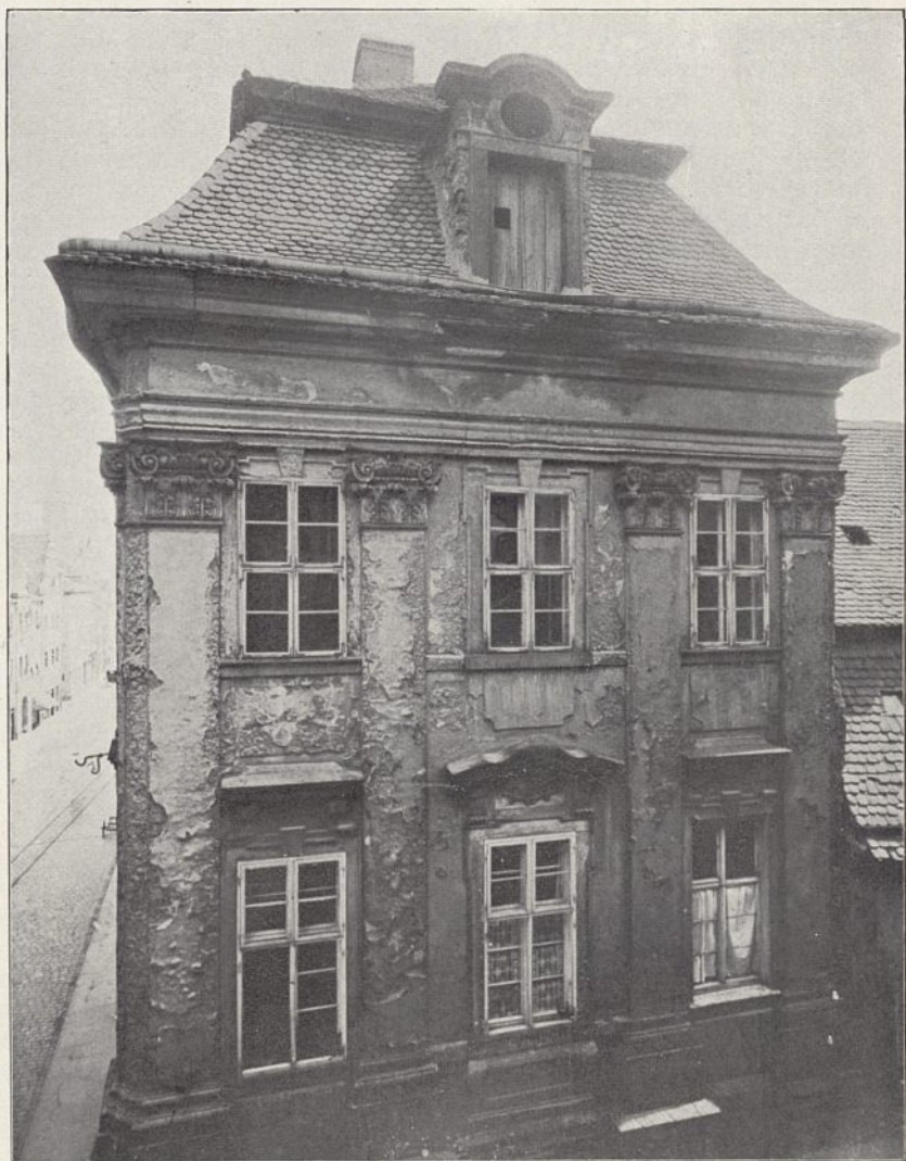
Verwahrloster Giebel des ehemaligen Palastes des Abtes von Teubus in Liegnitz, jetzt im Besitze des früheren Roffschlächters Schippke.
